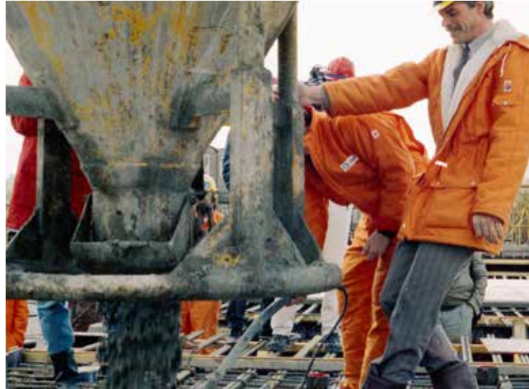
Støpearbeidene er så vidt i gang i byggedokken i Jättåvågen. Representanter fra byggherren setter arbeidet i gang ved å slippe ut den første betongen av betongtobben. Foto: Norwegian Contractors/Norsk Oljemuseum
