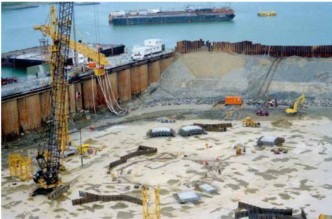
Anleggsområdet med byggedokken i Jåttåvågen ved Stavanger der Draugen skal bygges. Forberedende arbeider er i gang i tørrdokken. Foto: Norwegian Contractors/ Norsk Oljemuseum
