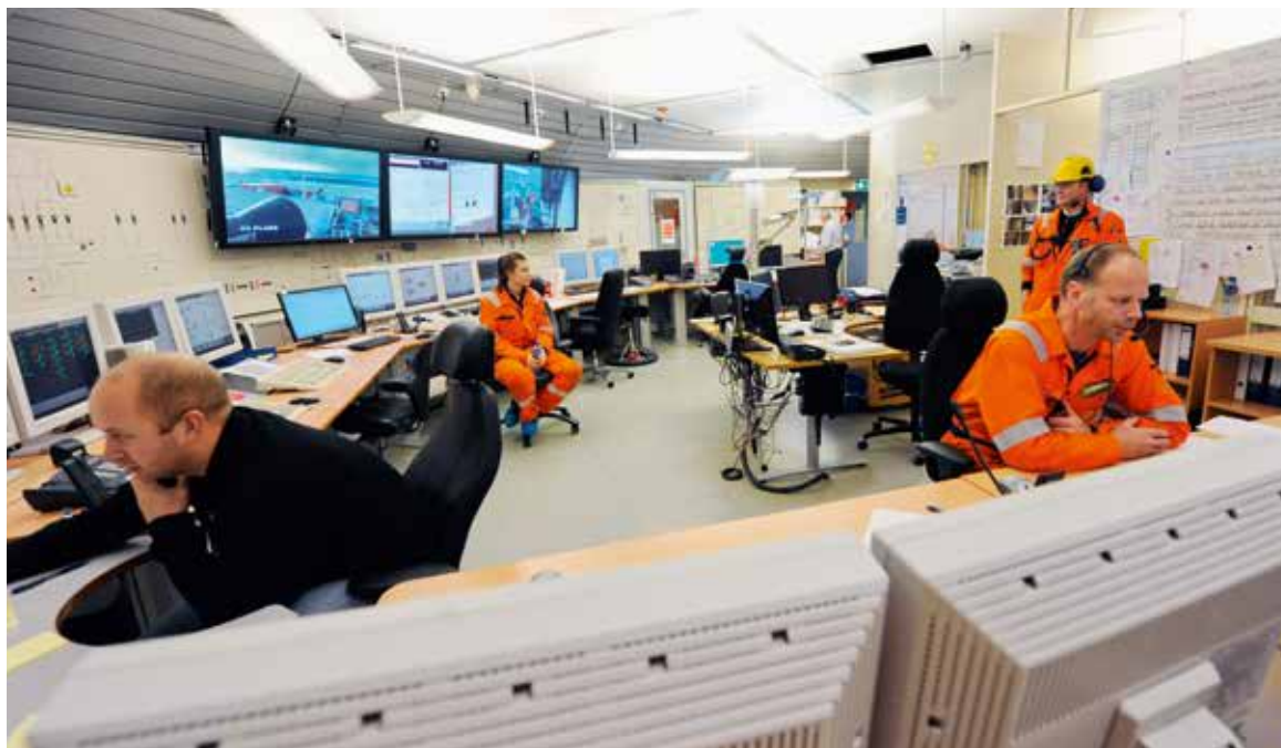
Arbeid på kontrollrommet i forbindelse med oppgraderinger som foregikk i en periode i 2013. Foto: A/S Norske Shell/Norsk Oljemuseum
