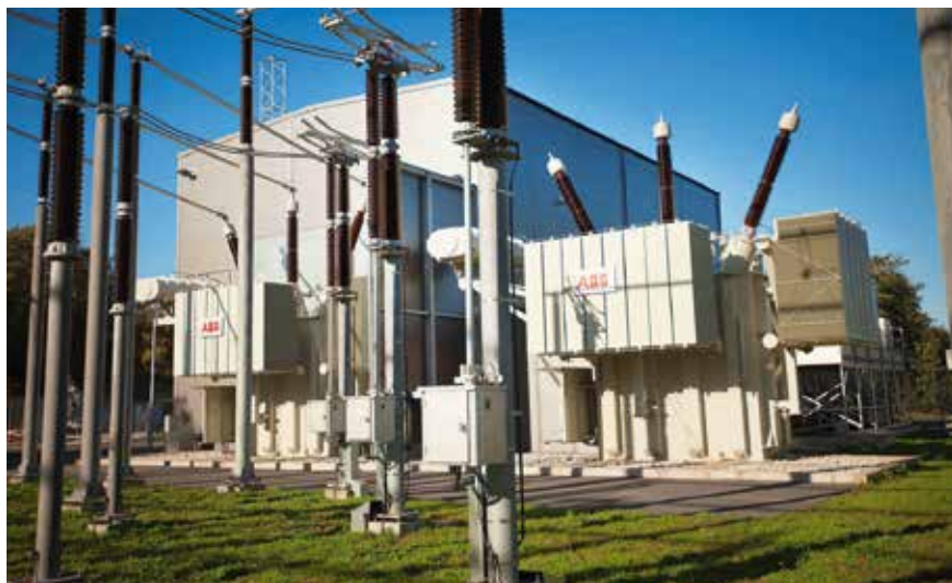
Omformerstasjon på Lista. Foto: BP Norge
