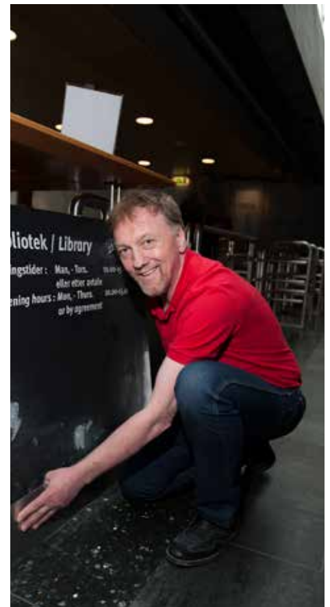
Stillingen som museumstekniker omfatter mange typer arbeid. Her monteres nye golvlister i museets resepsjonsområde. Foto: Shadè Barka Martins/Norsk Oljemuseum
